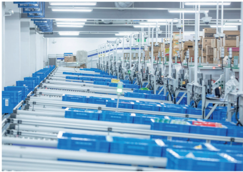
恒昌医药智慧物流仓储中心实现数字化管控。
