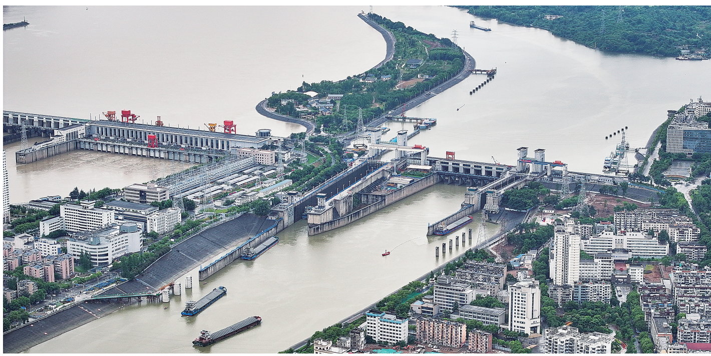
6月8日拍摄的三峡水运新通道工程葛洲坝航运扩能施工现场。
