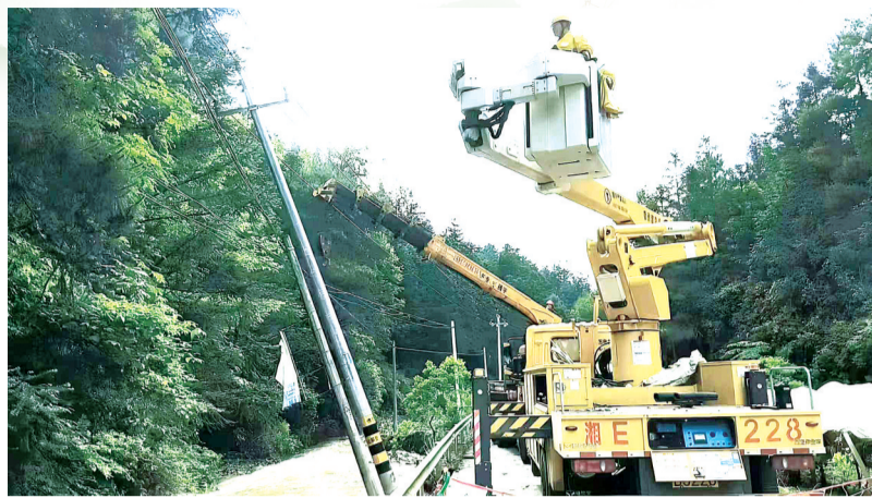
▲电力员工正在抢修受损供电线路。 ▼供电员工正在清理抢修通道。 (本文图片由黄信提供)
