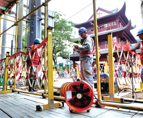
▼ 国网岳阳供电公司“电骆驼”共产党员服务队 在洞庭南路开展电力设备专项巡检。
