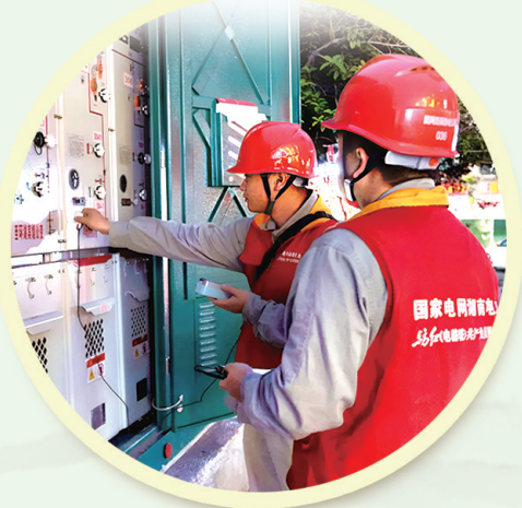
▲ 国网岳阳供电公司“电骆驼”共产党员服务队在岳阳楼景区开展电力设备专项巡检。
