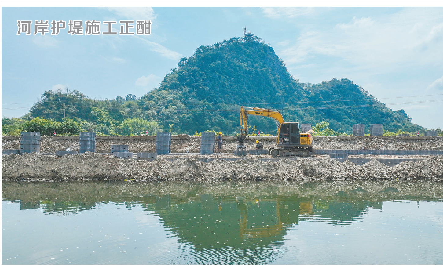
8月29日，道县清塘镇久佳村潇溪河沿岸，施工人员进行防护堤岸施工。连日来，该县抢抓枯水期积极开展河道整治、堤岸护坡等水利工程建设，确保汛期安全度汛，保障河岸安全。 蒋克青 于孝波 摄影报道(湖南图片库)
