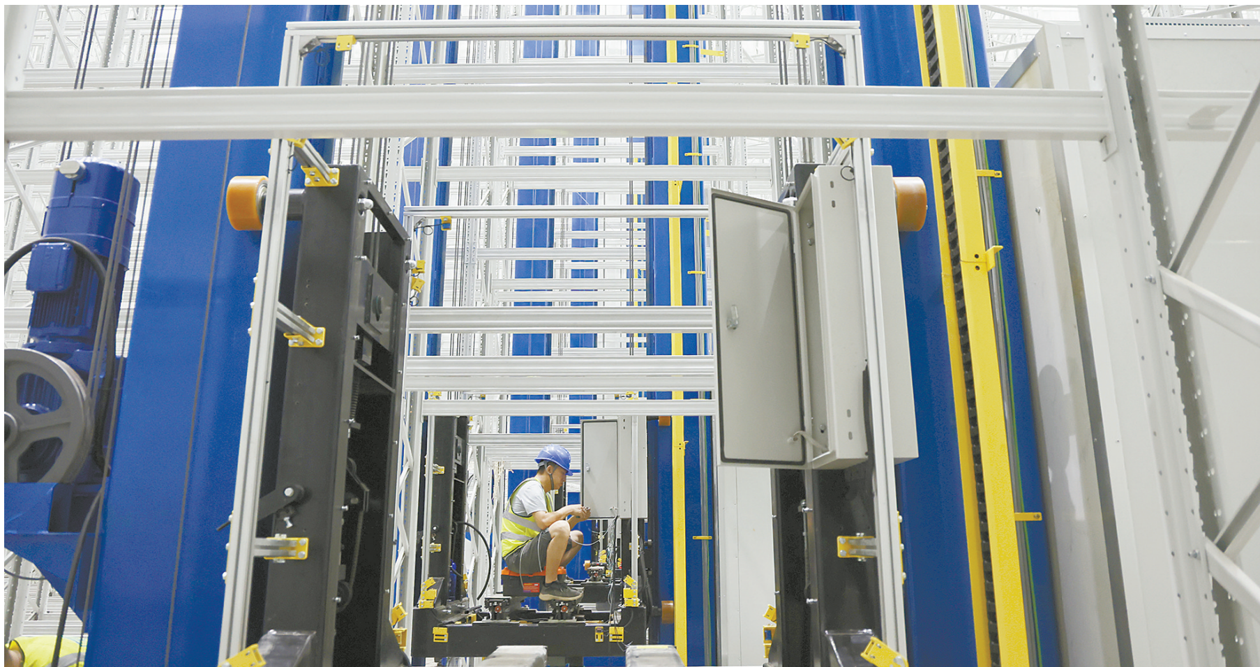
8月28日，怀化市国际陆港智慧冷链数字化物流中心项目，工人在调试设备。该项目冷库总容量达24万立方米，是湖南省内单体容量最大的智能化冷链仓储项目，预计9月试运行。 柴均林 李庆明 摄影报道 (湖南图片库)
