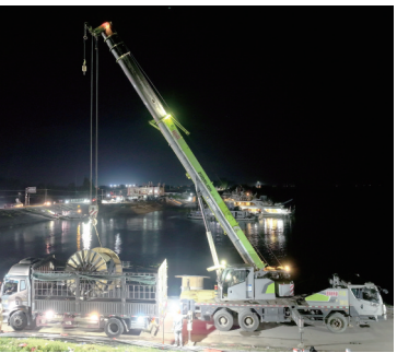
湖南送变电员工在华容县团洲垸架设电力线路。肖权一摄
