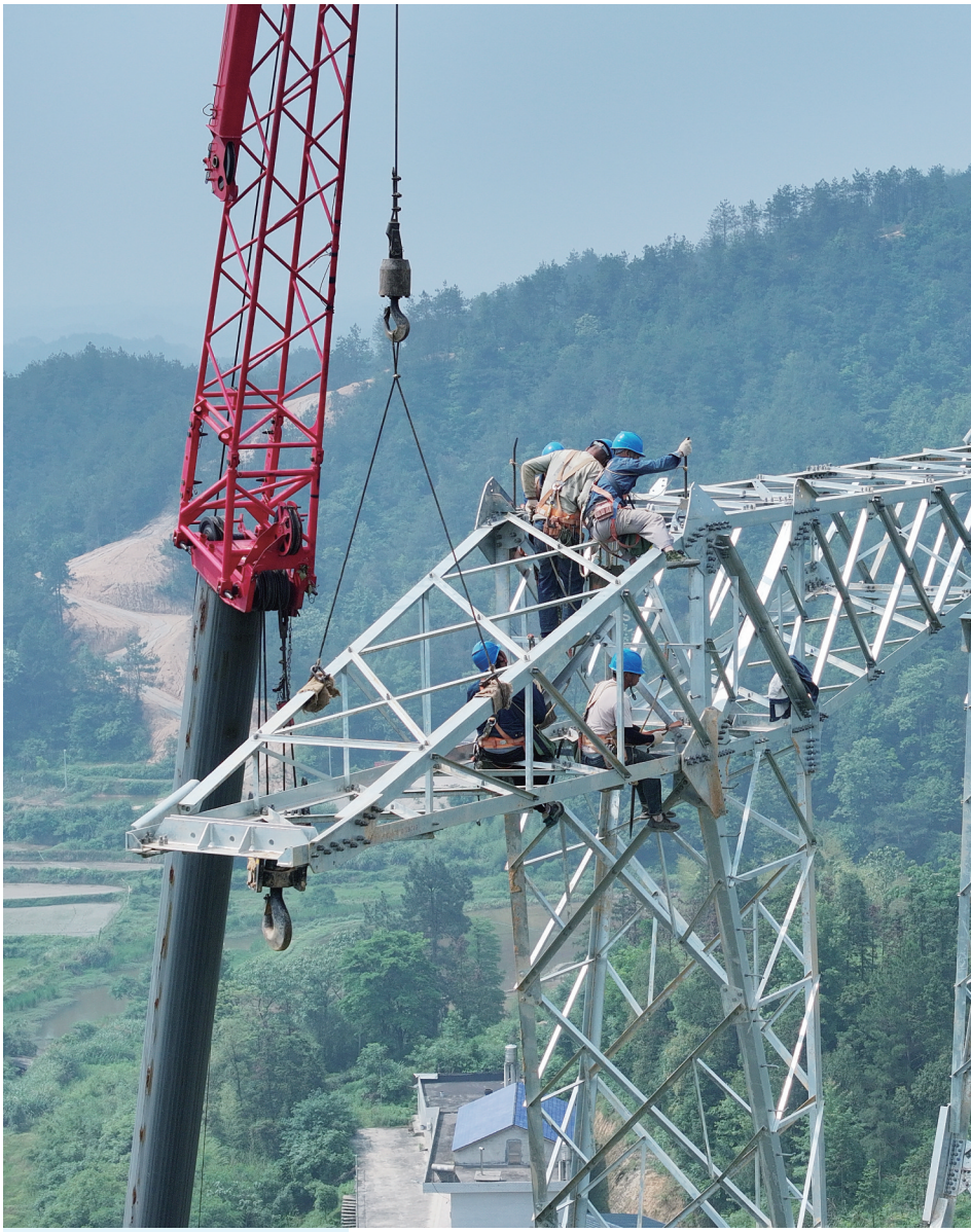
5月23日,湘乡市月山镇,湖南民丰-湘潭西第三回500千伏线路工程现场,湖南送变电工程公司员工正开展山地机械组塔。该工程是2024年湖南电网“迎峰度夏”重点工程之一,线路全长48.429千米,新建杆塔120基。 湖南日报全媒体记者 徐行 孟焱燕 摄影报道
