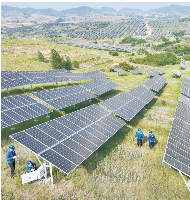
5月22日，第七届中国(日照)新闻摄影周暨“共同谱写中国式现代化日照篇章”全国百家媒体聚焦日照新闻摄影采访活动开幕，来自全国新闻界的媒体人，以各自的视角聚焦这座海滨城市的人文之美和生态之美。图为当日，山东省日照市东港区三庄镇90MW集中式农光互补光伏电站，工作人员巡检光伏发电设施。 湖南日报全媒体记者 辜楠博 摄
