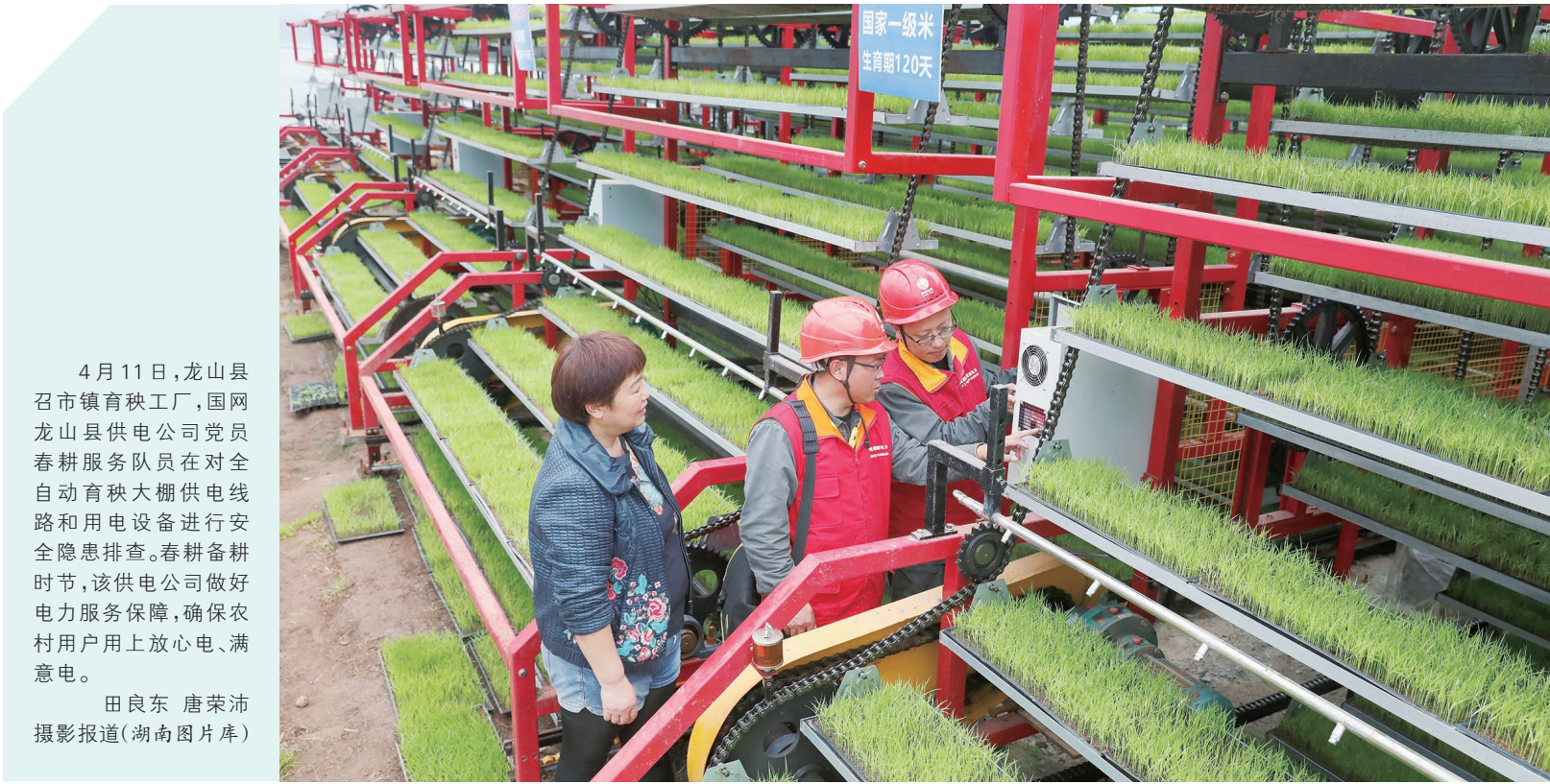
4月11日,龙山县召市镇育秧工厂,国网龙山县供电公司党员春耕服务队在对全自动育秧大棚供电线路和用电设备进行安全隐患排查。春耕备耕时节,该供电公司做好电力服务保障,确保农村用户用上放心电、满意电。 田良东 唐荣沛 摄影报道(湖南图片库)
