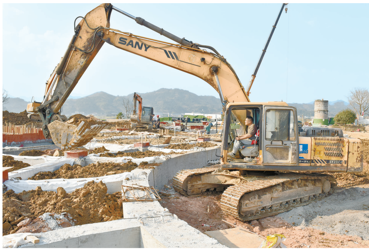
2月19日，洪江市安江杂交水稻博物馆建设工地，工人抢抓晴好天气加紧施工。该项目占地37096平方米，建筑面积15041平方米，主体建筑按“喜看稻菽千重浪，而今禾下好乘凉”的设计理念设计。 杨锡建 向华 摄影报道 (湖南图片库)
