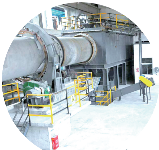
五矿钨业含钨废渣处理设备之一。
