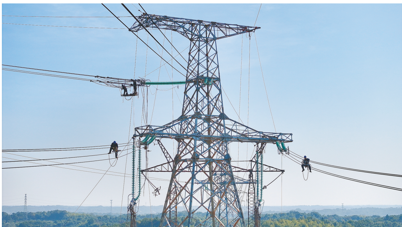
2023年11月17日,益阳市赫山区,益阳东500千伏变电站配套线路工程D17号铁塔施工现场,国网湖南送变电工程公司高空作业人员在近百米高空进行线路检修、消缺工作。该工程为湖南迎峰度冬重点建设工程,建成投运后将满足益阳市中东部地区用电负荷快速增长的需求。 湖南日报全媒体记者 童迪 摄
