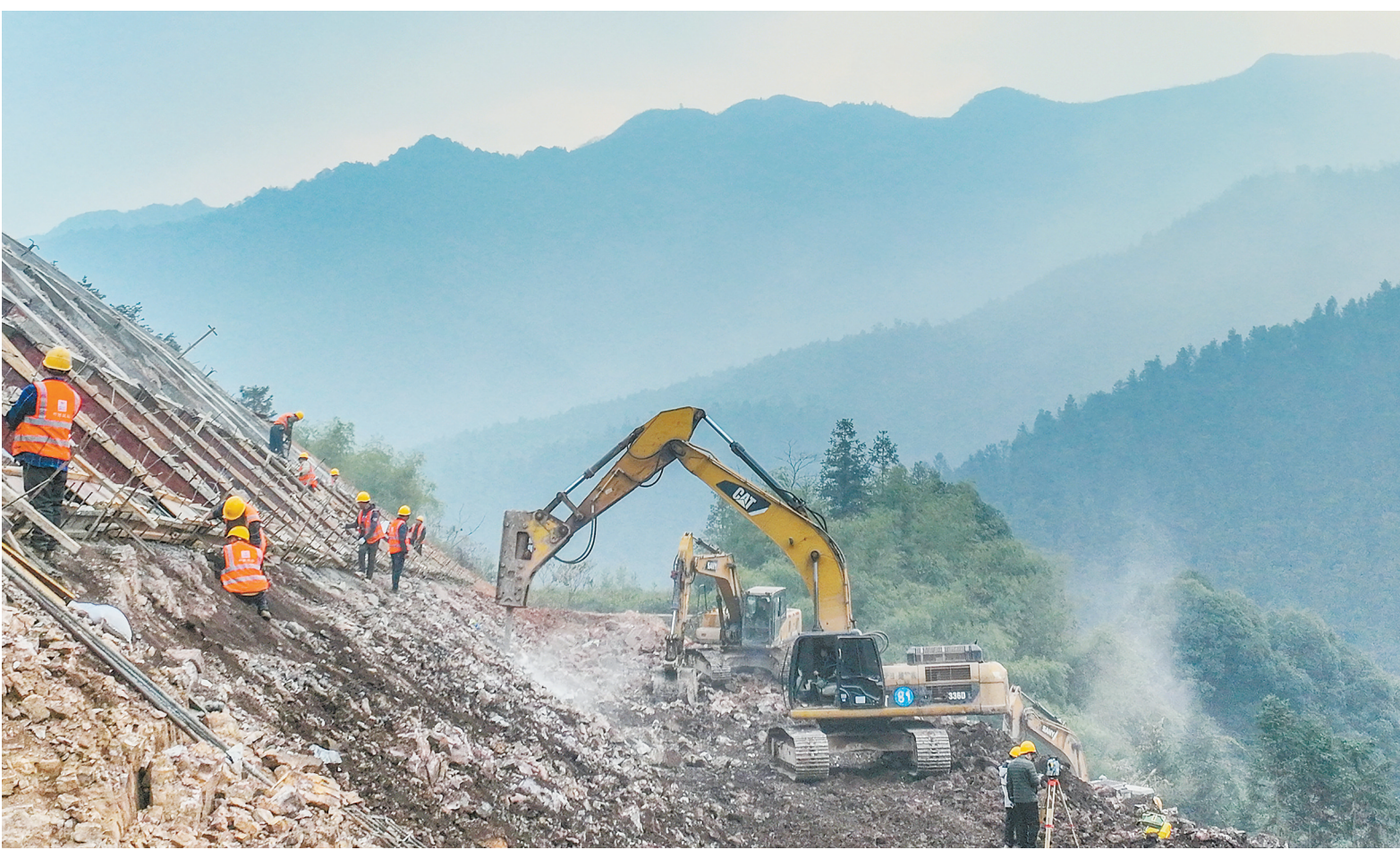
2023年12月31日，工人在永州市零道县(零陵至道县)高速建设项目工地施工。元旦假期，项目建设者们坚守岗位，确保工程如期推进。 蒋克青 摄
