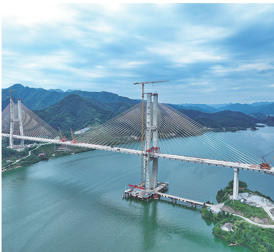
7月7日上午9时许,官(庄)新(化)高速控制性工程——雪峰湖大桥成功合龙,标志着官新高速主线全线贯通。 湖南日报全媒体记者 童迪 摄
