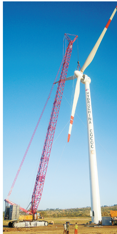
三一设备承建埃塞俄比亚阿达玛风电项目。(本版图片均由相关企业提供)
