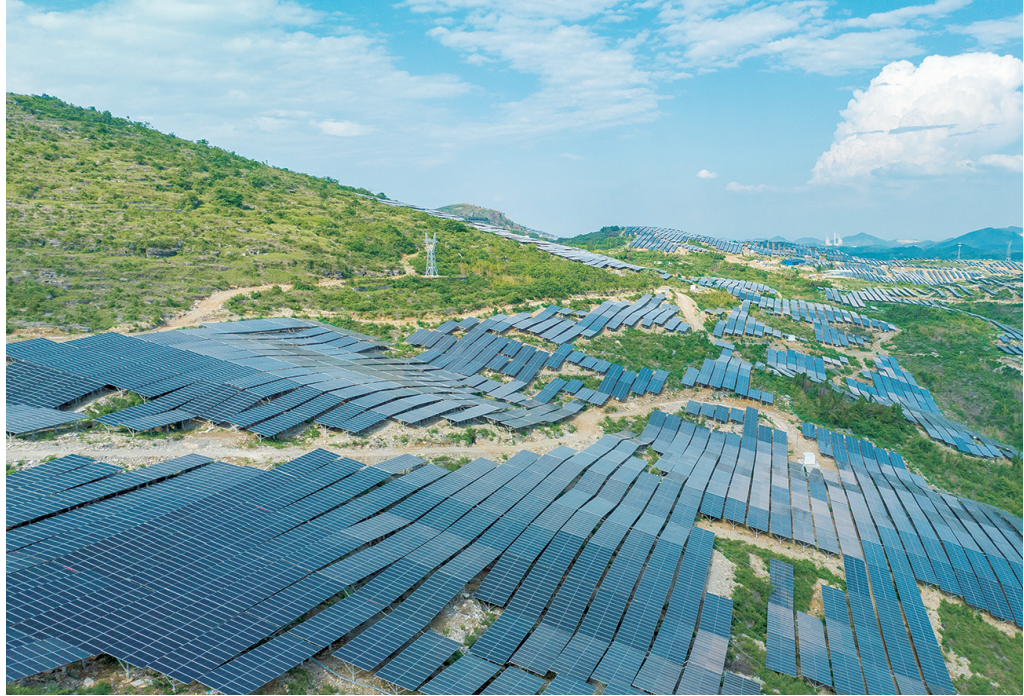
5月26日,国家首批大型光伏基地项目——大唐华银湖南娄底生态治理光伏发电项目基地蔚为壮观。该项目一期规划容量100万千瓦,现已完成并网60%,并网发电6000多万度。 吴永华 摄
