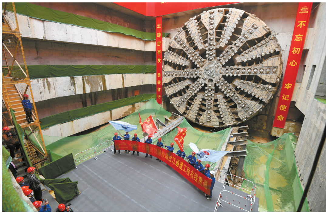
3月12日上午，中铁十四局长沙湘雅路过江通道项目右线盾构接收井内，“星盛号”盾构机巨大刀盘破墙而出，右线盾构隧道顺利贯通，标志着湖南省在建最大直径盾构隧道实现双洞贯通。
