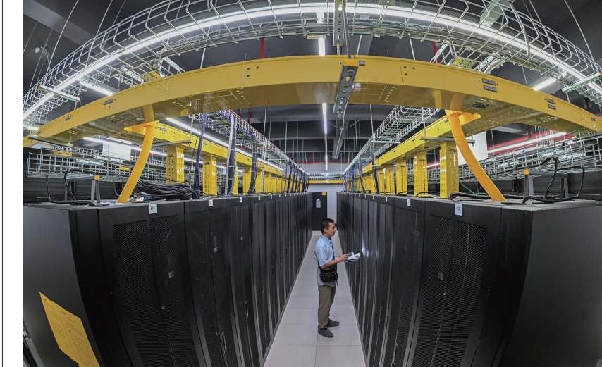
资兴市东江湖大数据中心,工作人员在机房里进行设备运行巡查。
