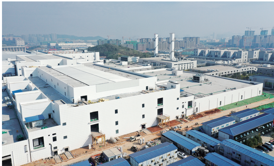
10月25日，湖南湘江新区长理锂科车用锂电池扩产项目，二期工程建设进入最后冲刺阶段，正在进行设备和工艺安装。该项目是湖南省十大产业项目之一，总投资100亿元。湖南日报全媒体记者 田超 摄
