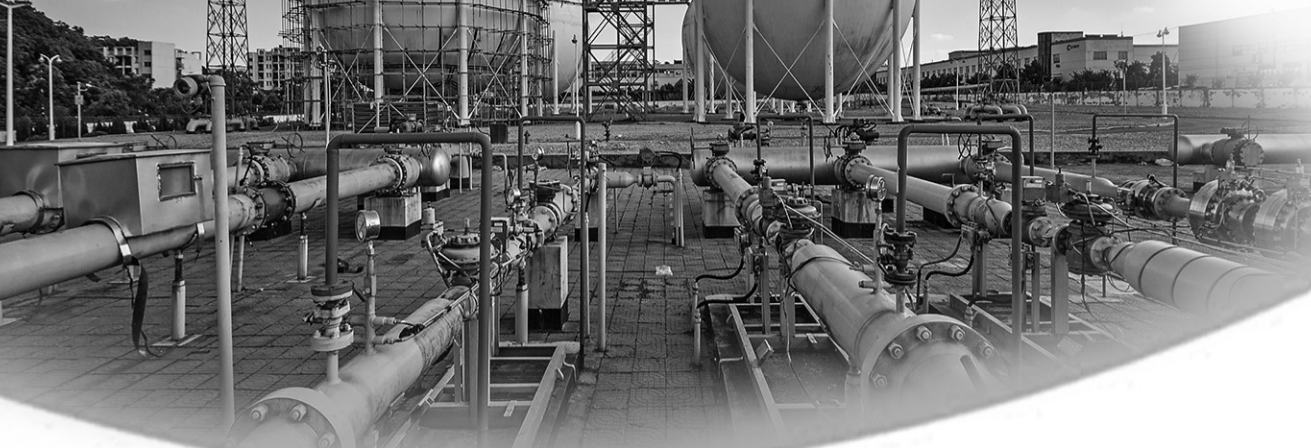
长沙新奥燃气河西球罐储备站。陈飞 摄
