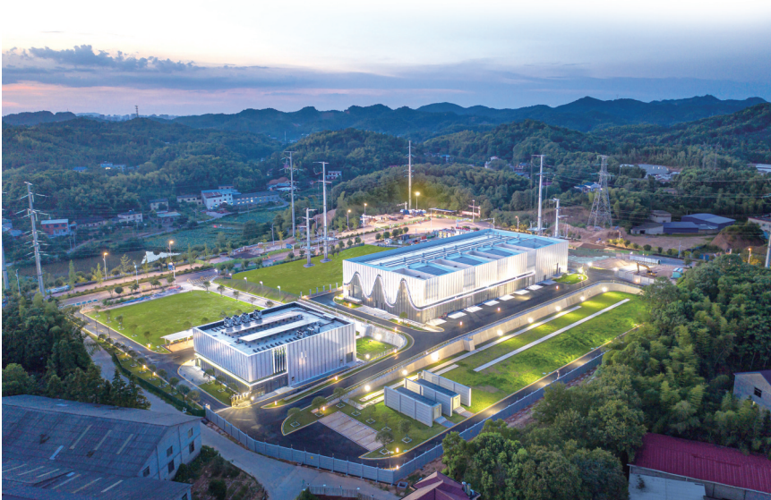
株洲成家220千伏智慧能源站。
