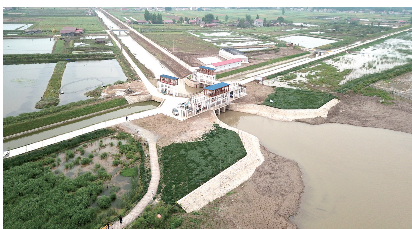
洞庭湖北部水资源配置安乡补水工程项目(豆港泵站新建工程)施工。
