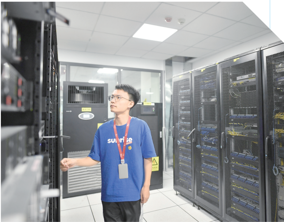
6月20日，麒麟软件有限公司，工作人员在检查机房。
