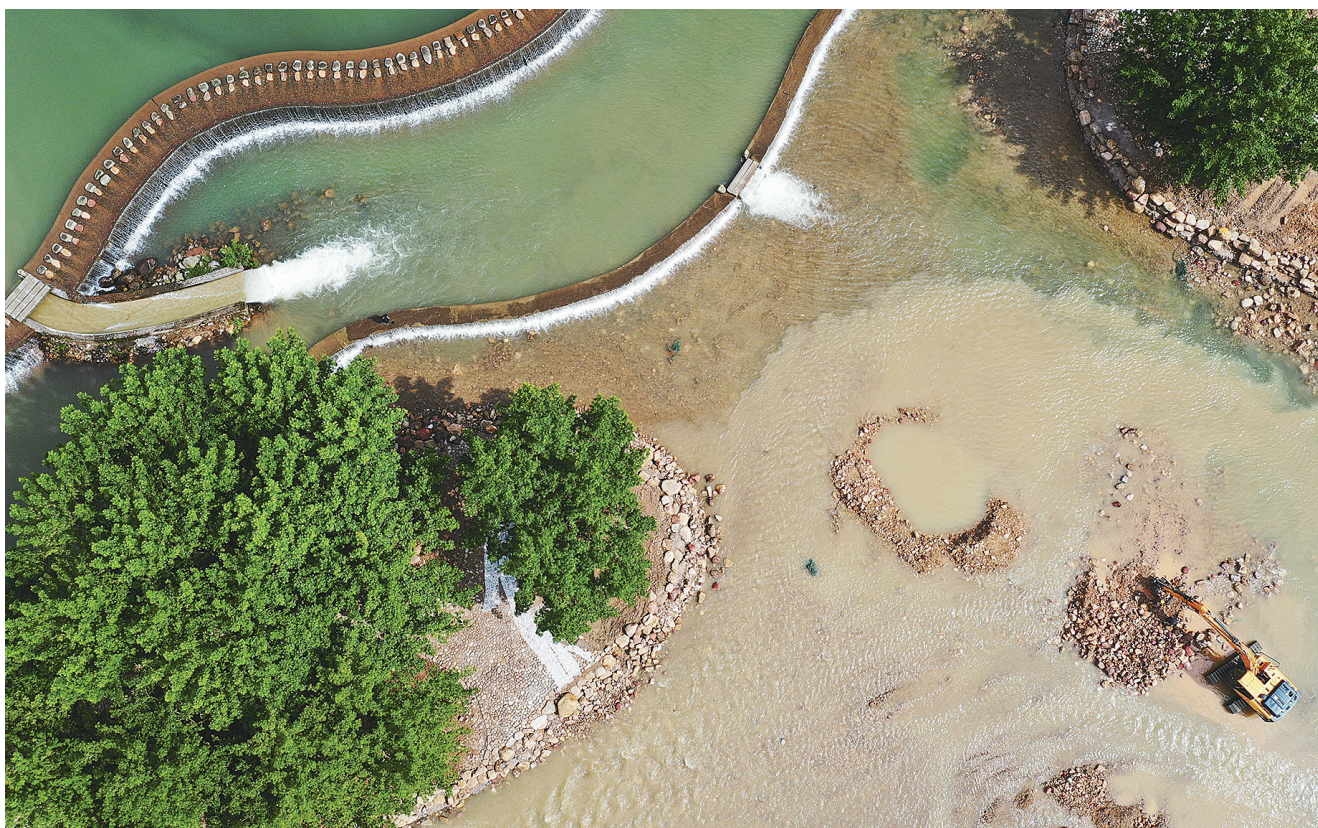
水中“捞”景 5月29日,工人操控控机在河道上施工。近期,张家界市武陵源区打造索溪河水利景观,既满足防洪、排洪需要,又营造和谐的水环境,为市民和游客提供亲水休闲的场所。 吴勇兵 摄
