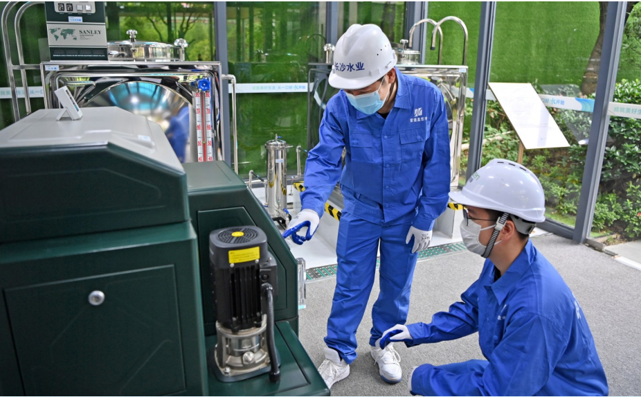
5月19日,长沙市岳麓区新城观山印小区,长沙水业工作人员在管道直饮水试点项目设备房巡检。今年,长沙水业集团长沙水思源产业发展有限公司首次在住宅小区试点管道直饮水项目,致力于提供健康、便捷、经济的管道直饮水,以满足广大城市居民对更高品质饮用水的需求。 湖南日报全媒体记者 李健 王文 摄影报道
