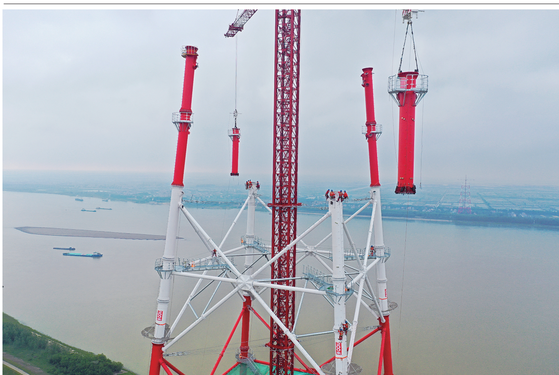
4月25日，位于临湘市的螺山长江大跨越工程，工人在南岸跨越铁塔上进行组立施工。由国网特高压建设公司建设管理、山东送变电工程有限公司承建的该工程，是1000千伏南阳—荆门—长沙特高压交流工程的重要节点工程。其跨越塔设计全高371米，是目前世界上最高的特高压输电铁塔。目前，南岸跨越铁塔已组塔过半，预计6月底完成组塔施工。 湖南日报全媒体记者 郭立亮 摄
