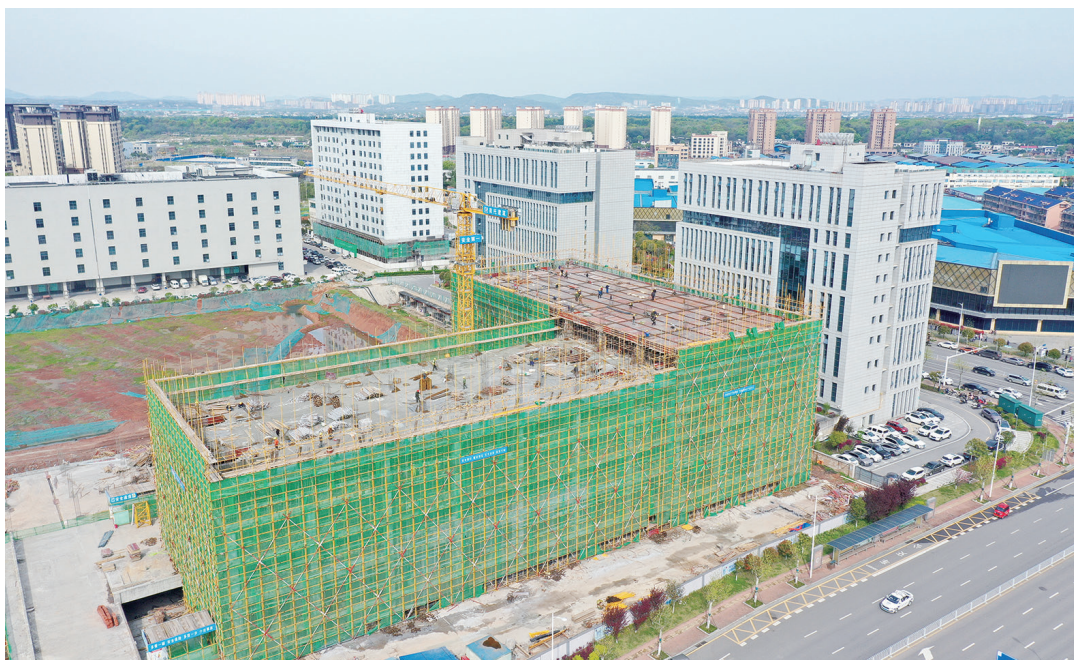
3月29日，长沙市天心软件园二期项目现场，150余名工人在加紧主体建筑施工。该产业园总占地面积130亩，计划总投资20亿元。目前已聚集了70多家企业。二期项目占地80亩，地上主体建筑共5层，有望于6月初封顶。项目建成后，将引进500余家相关企业，年产值40亿元以上。湖南日报全媒体记者 田超 张福芳 摄影报道
