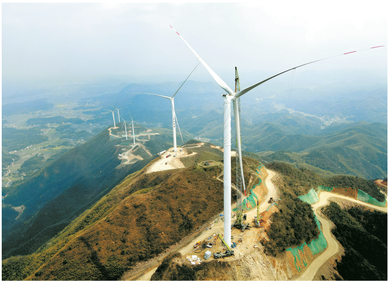
3月13日，湘潭县昌山生态风电场建设现场，工人在吊装叶轮。该风电场项目设计装机规模44MW，计划投资约4.15亿元。建成投产后，预计项目年上网发电量为9688万千瓦时，有助于改善当地能源结构，推动当地经济发展。 李建新 摄
