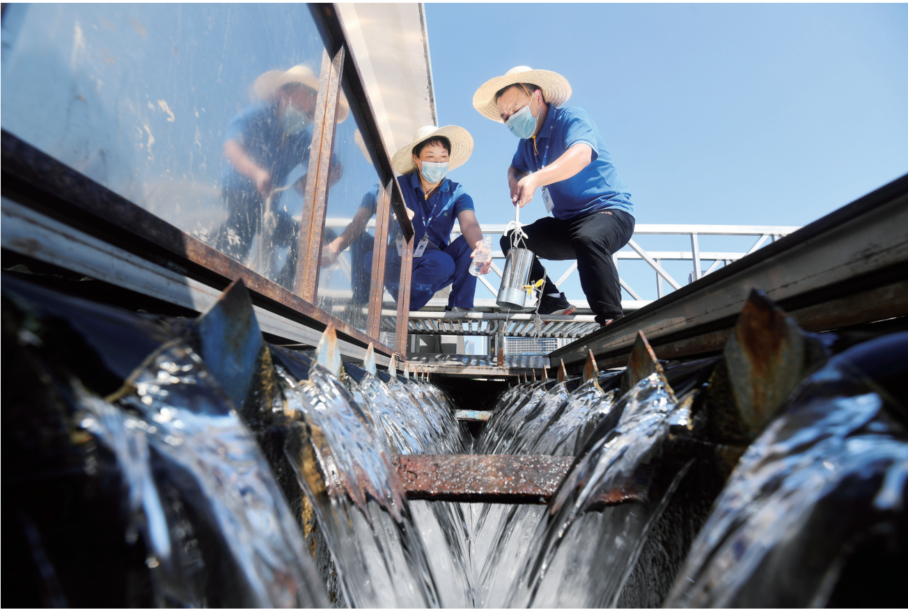
8月31日,长沙水业集团银盆岭水厂,工作人员在提取沉淀池监测水样。
