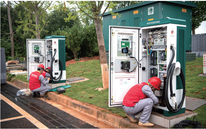
响应国家“碳达峰、碳中和”号召，加快充电桩建设。
