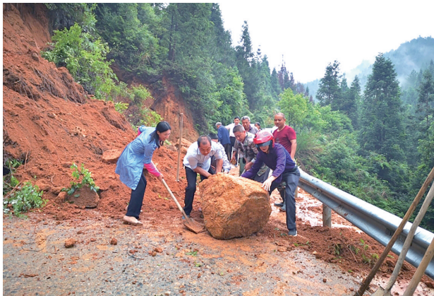
普乐镇“村务员”清理塌方路面。(本文图片均由桂东县融媒体中心提供)
