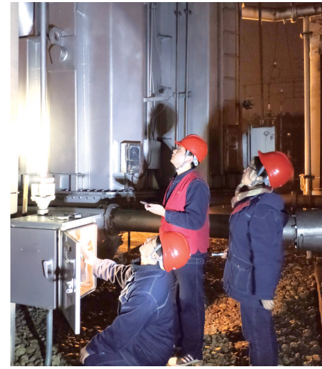
电网安全，关乎民生。长沙“电雷锋”夜以继日，守护电网安全“生命线”。
