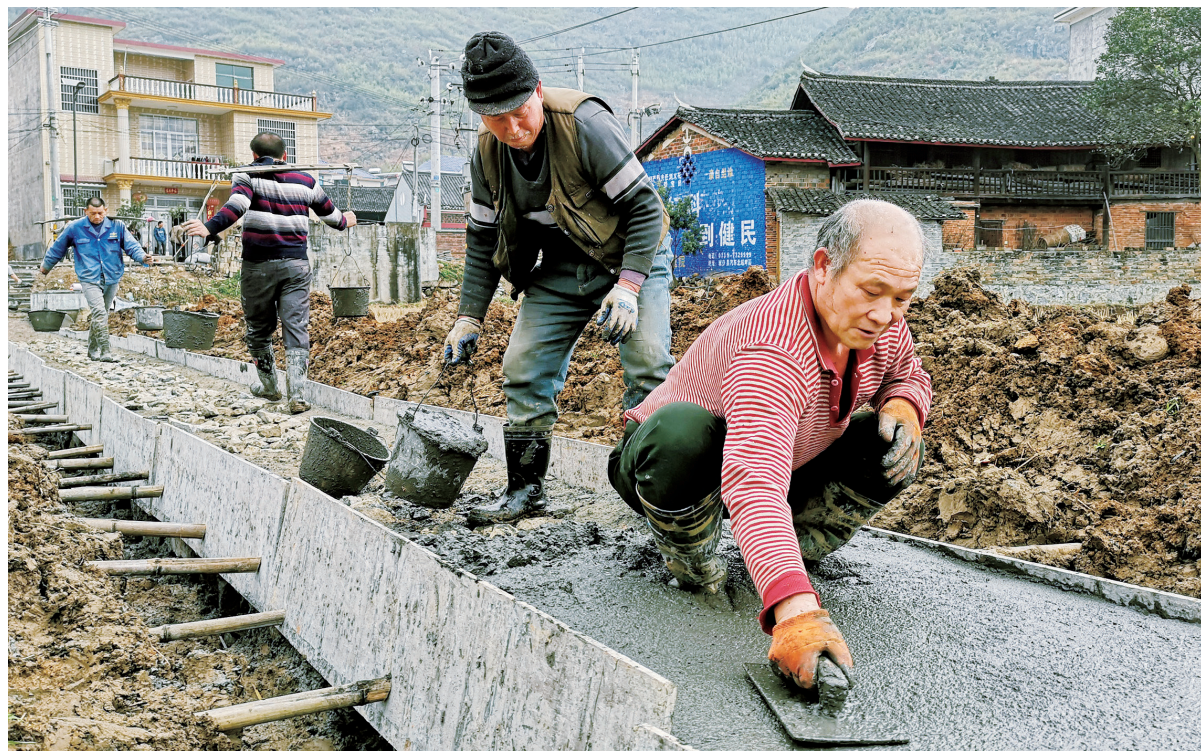
2月4日,城步苗族自治县儒林镇清溪村,村民在硬化田间道路。最近,该县农民利用年前的空闲时间,抓紧开展疏浚水渠、道路修整等工作,为年后的农业生产做准备。 严钦龙 摄
